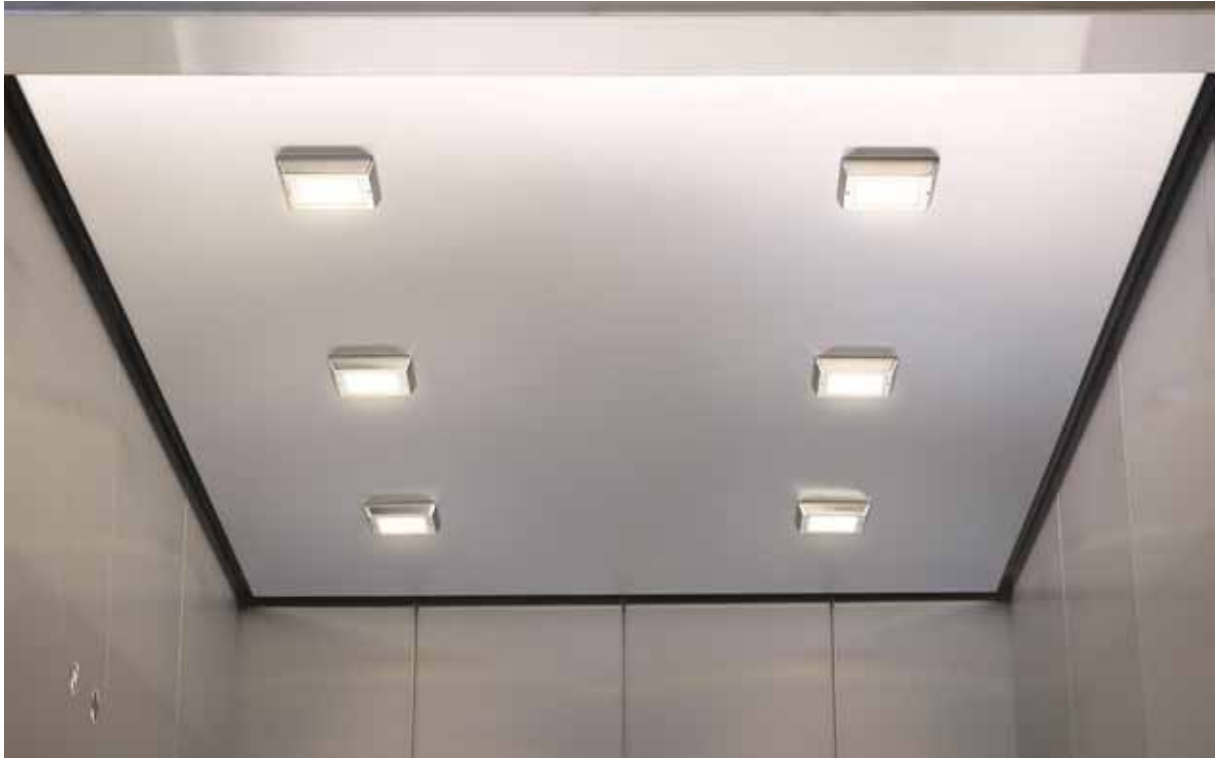
Decke Edelstahl mit LED Flatlight Spot q90
